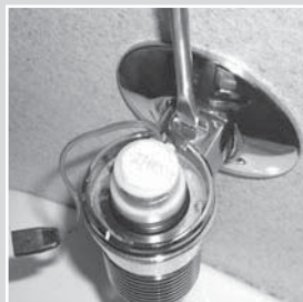
Achtung! Wasserabspernung schließen.
